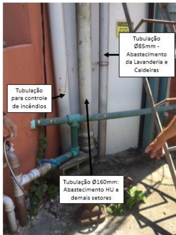
Figura 3 - Tubulações que derivam da caixa d'água.
