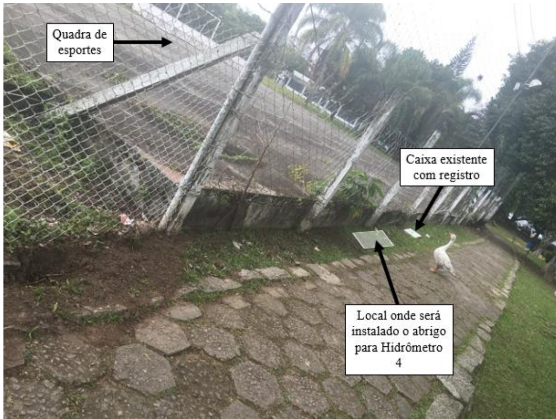
Figura 7 - Localização do registro existente e da instalação do Hidrômetro 4.
