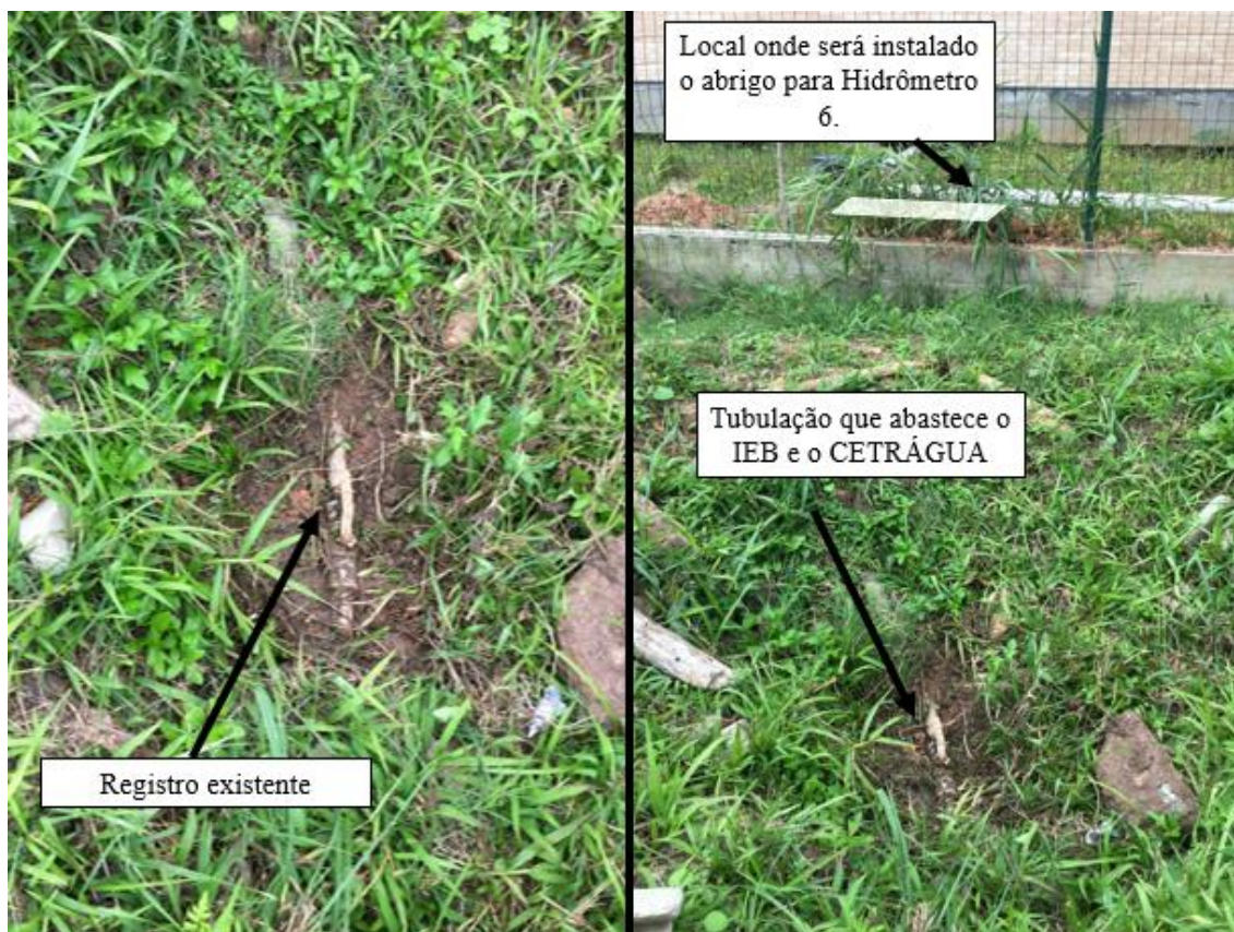
Figura 9 - Localização do registro existente, da instalação do Hidrômetro 6.
